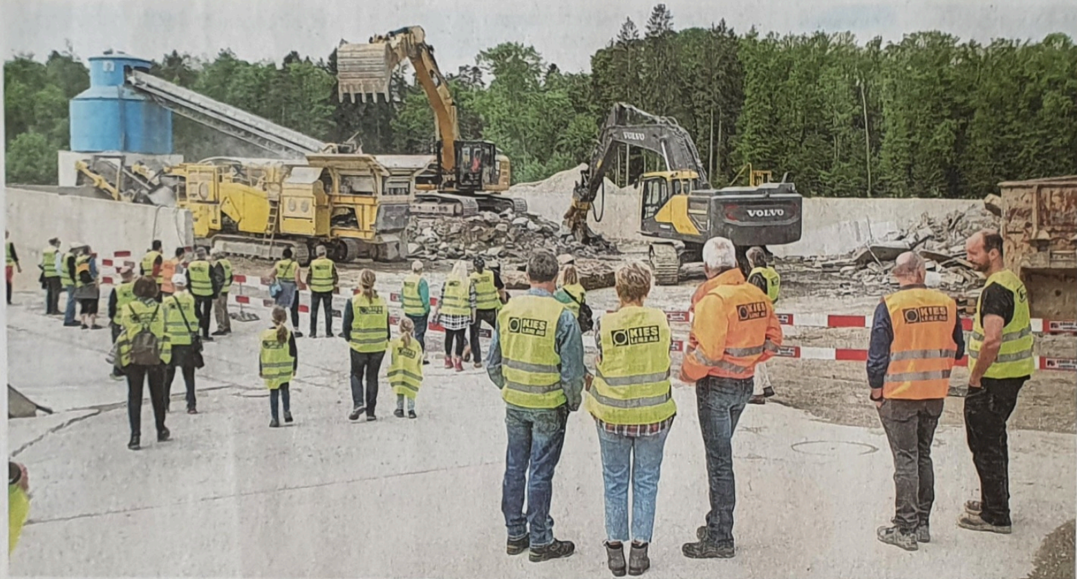
Betonbrecher bei der Arbeit: Besucher konnten vor Ort miterleben, wie alte Betonstücke zu kleinstem Material werden.
